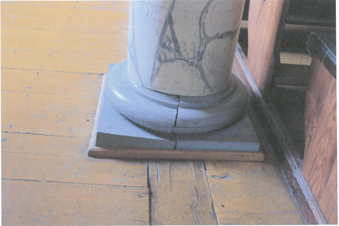
2. Uszkodzona baza kolumny w kościele św. Trójcy w Suwałkach – stan obecny
